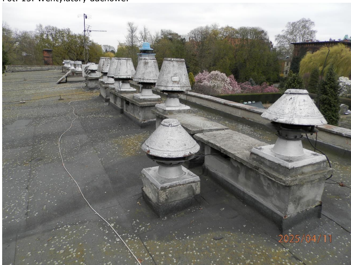
Fot. 13. Wentylatory dachowe.
