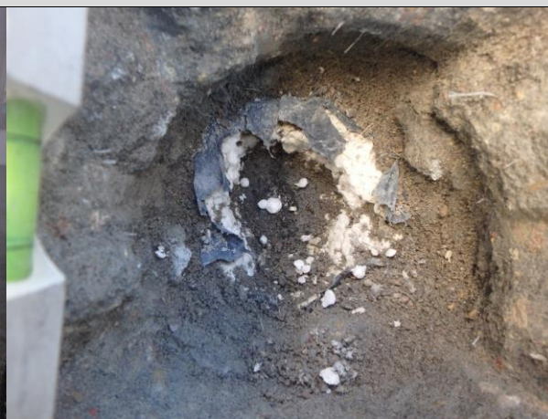
Fot. 03_21. Pod styropianem, na powierzchni płyty stropowej obecność izolacji z papy.
