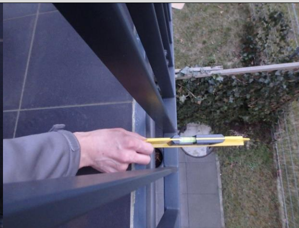
Fot. 15. Obróbki krawędziowe ze zdecydowanym spadkiem w kierunku „od budynku” – prawidłowo.
