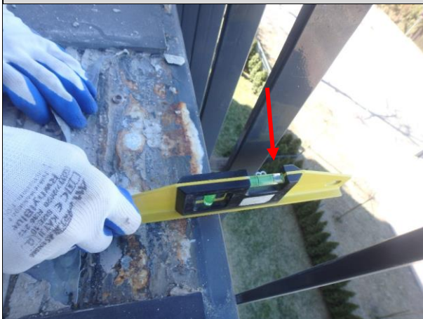
Fot. 01_12. Stwierdzone lokalne (miejscowe) przeciwspadki mogące stanowić utrudnienie dla odpływu wody z poziomu izolacji podpłytkowej. Czerwoną strzałką wskazano położenie oczka libelli.
