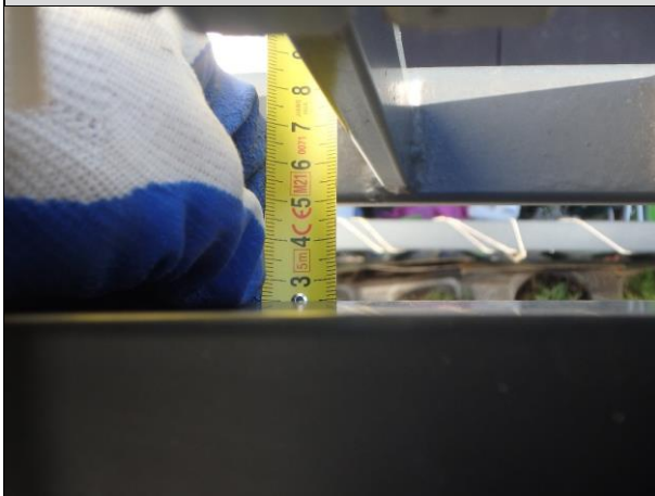
Fot. 10. Miejscowe nieprawidłowości w wielkości okapnika obróbki blacharskiej. Tu 25mm (powinno być min 30mm)
