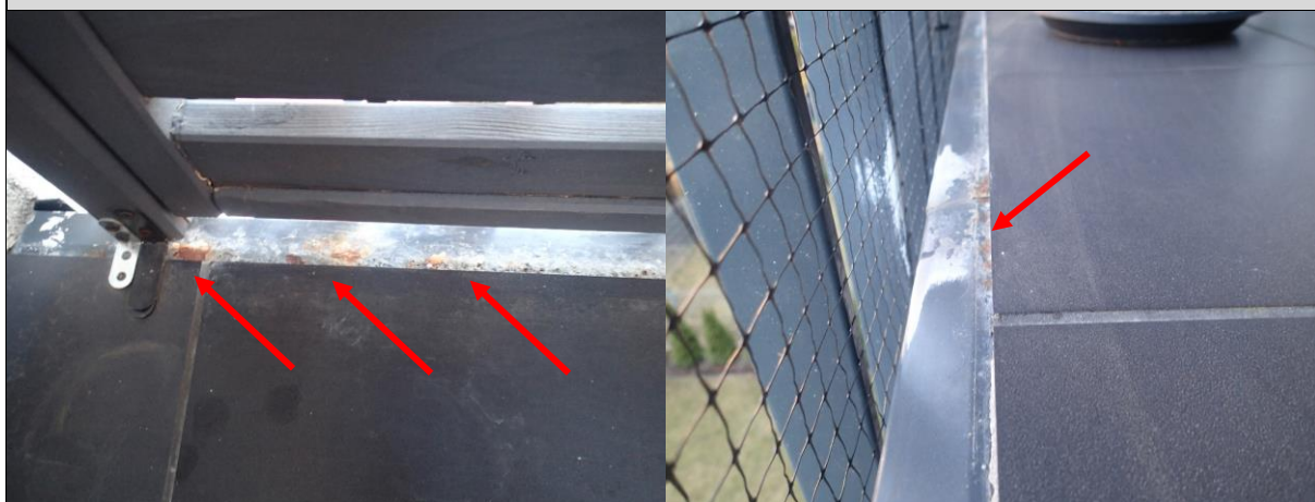
Fot. 3. Stwierdzona korozja krawędziowych obróbek blacharskich. Zaobserwowano tendencję do silniejszej korozji w miejscu styku obróbki z okładziną ceramiczną niż w strefie kapinosa.
