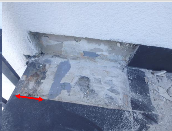
Fot. 02_9. Zastosowane taśmy uszczelniające z fizeleinową częścią montażową. Taśmy przyklejane do obróbki przy pomocy kleju. Rozwiązanie dopuszczalne aczkolwiek lepszym (zdaniem zespołu opiniującego) rozwiązaniem jest stosowanie „samoprzylepnych” taśm butylowych. Taśma wklejona zbyt daleko od krawędzi balkonu – powinna być wklejona tak aby wyeliminować kontakt zaprawy klejowej z obróbką blacharską. Czerwoną strzałką oznaczono zakres kontaktu kleju z obróbką blacharską.
