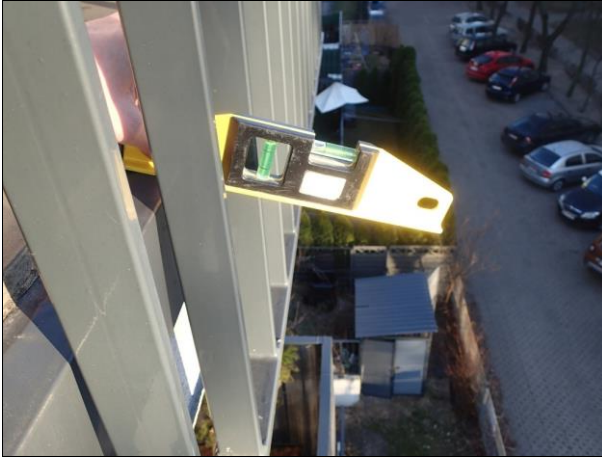
Fot. 40. Obróbki krawędziowe ze zdecydowanym spadkiem w kierunku „od budynku” – prawidłowo.
