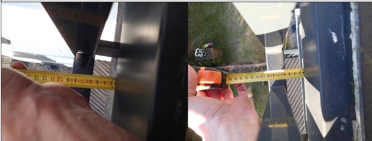
Fot. 9. Miejscowe nieprawidłowości w wielkości kapinosu obróbki blacharskiej. Tu 26mm (powinno być min 30mm)
