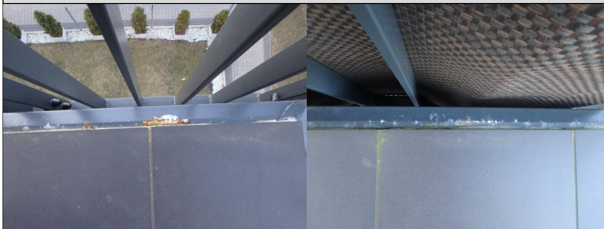
Fot. 4, 5. Stwierdzona korozja krawędziowych obróbek blacharskich. Zaobserwowano tendencję do silniejszej korozji w miejscu styku obróbki z okładziną ceramiczną niż w strefie kapinosu
