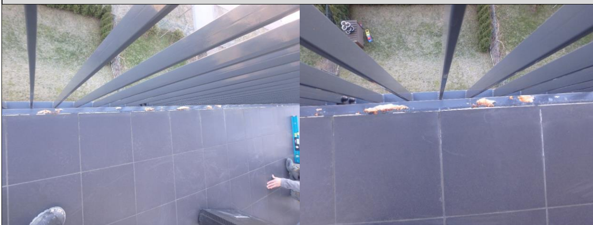
Fot. 11, 13 . Stwierdzona korozja krawędziowych obróbek blacharskich. Zaobserwowano tendencję do silniejszej korozji w miejscu styku obróbki z okładziną ceramiczną niż w strefie kapinosa.
