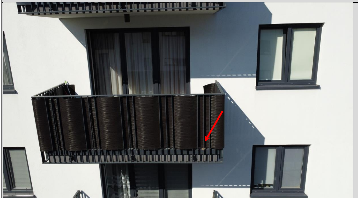
Fot. DR25_EE22. Przykład skorodowanej obróbki blacharskiej na elewacji wschodniej. Czerwoną strzałką oznaczono miejsce zaobserwowanej korozji.
