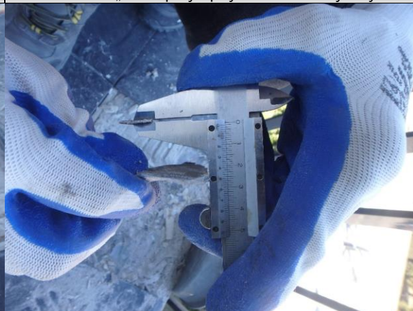
Fot. 01_16. Zmierzona grubość izolacji podpłytkowej w miejscu odkrywki od 1,4mm do 1,7 mm. Nieprawidłowo – powinno być min 2mm.
