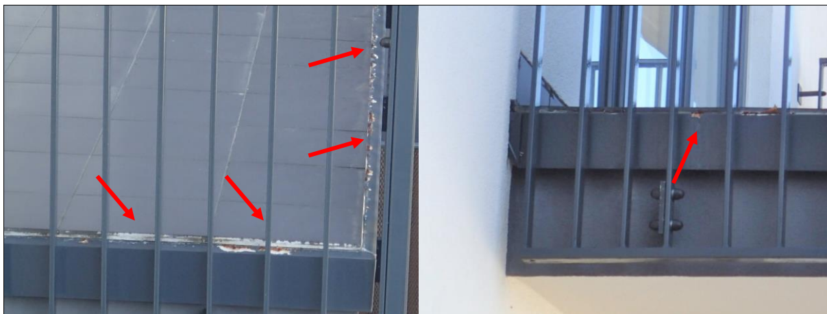
Fot. 35(kadr), 36(kadr). Korozja obróbek blacharskich balkonów sąsiadujących z lokalem nr 37.
