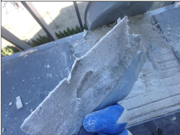
Fot. 01_14. Zespoleńie taśm izolacyjnych z izolacją podpłytkową prawidłowe (fot. 01_14).
