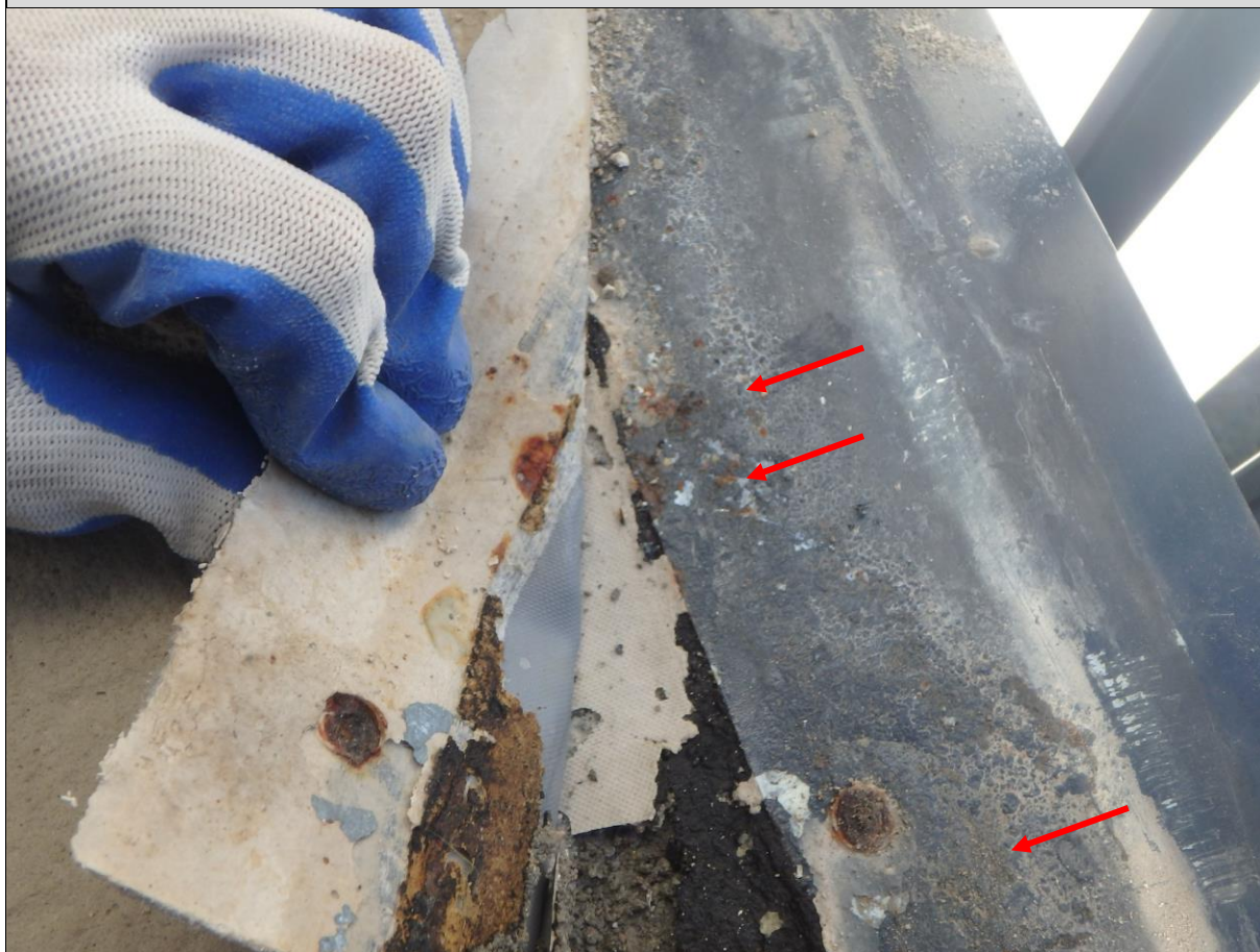
Fot. 03_7. Pod płytka, pod taśmami izolacyjnymi stwierdzone odparzenie lakieru od obróbki oraz zaczątki korozji obróbek blacharskich.
