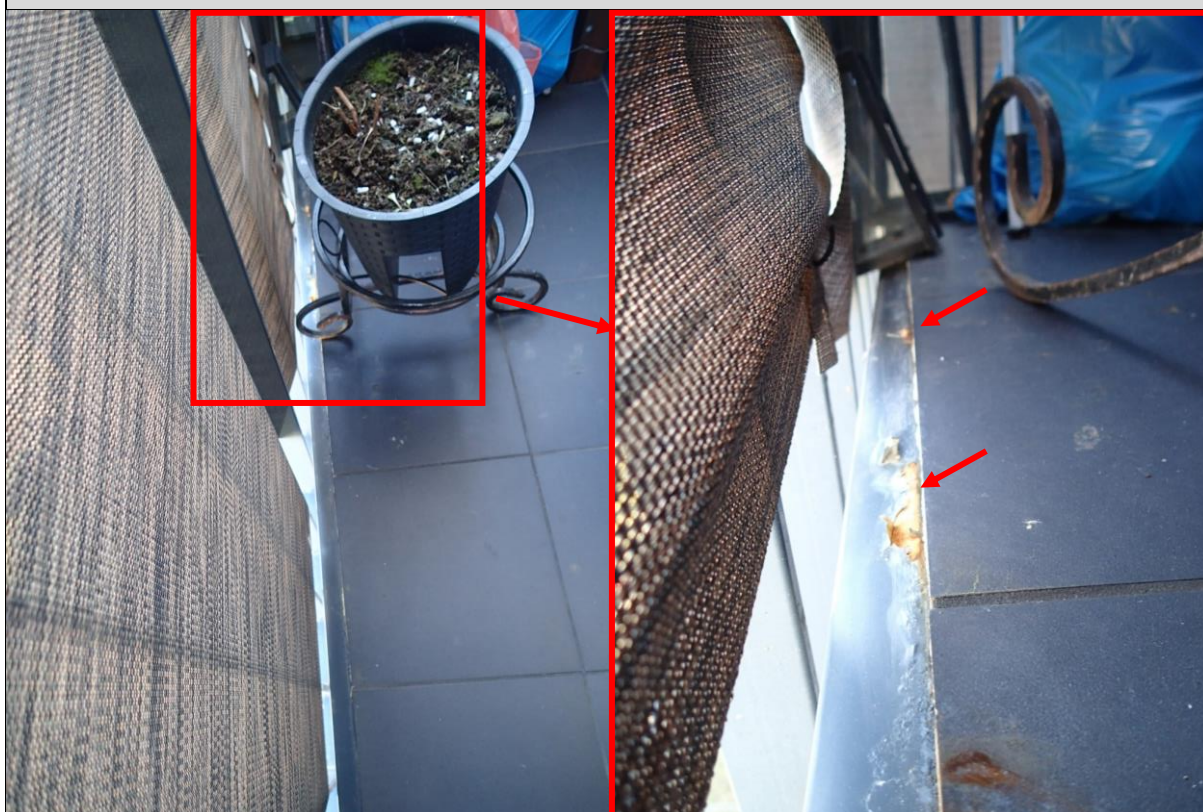
Fot. 1, 2, . Stwierdzona korozja krawędziowych obróbek blacharskich. Zaobserwowano tendencję do silniejszej korozji w miejscu styku obróbki z okładziną ceramiczną niż w strefie kapiosiu.
