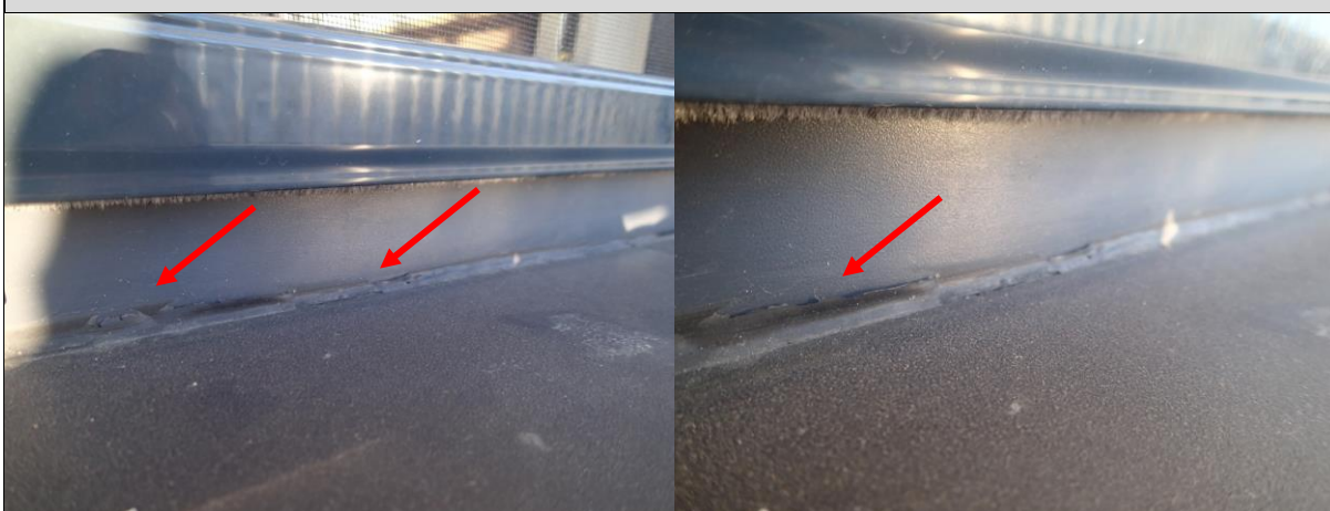
Fot. 34, 35 . Miejscowe odspojenia uszczelniacza poliuretanowego w miejscu styku ościeżnicy drzwiowej z okładziną ceramiczną.
