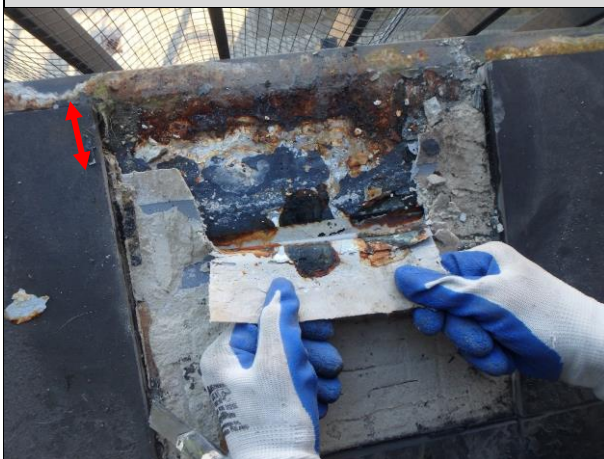
Fot. 04_4. Zastosowane taśmy uszczelniające z fizeolinową częścią montażową. Taśmy przyklejane do obróbki przy pomocy kleju. Rozwiązanie dopuszczalne aczkolwiek lepszym (zdaniem zespołu opiniującego) rozwiązaniem jest stosowanie „samoprzylepnych” taśm butylowych. Taśma wklejona zbyt daleko od krawędzi balkonu – powinna być wklejona tak aby wyeliminować kontakt zaprawy klejowej z obróbką blacharską. Czerwoną strzałką oznaczono zakres kontaktu kleju z obróbką blacharską.
