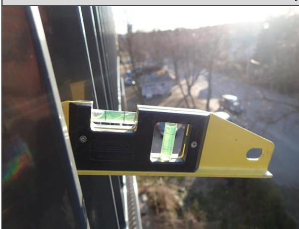
Fot. 22. Obróbki krawędziowe ze zdecydowanym spadkiem w kierunku „od budynku” – prawidłowo.
