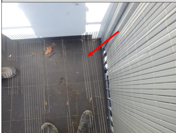
Fot. 03_1. Miejsce wykonania odkrywki – przy obróbce blacharskiej bez jakiegokolwiek zewnętrznej oznaki korozji.
