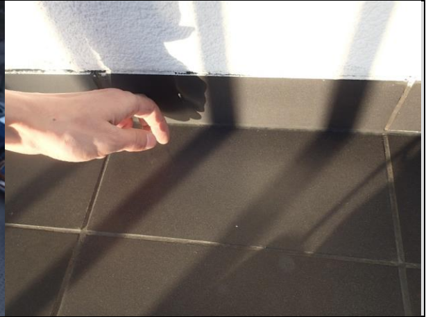
Fot. 38. Miejscowe odspojenie płytki cokołowej.
