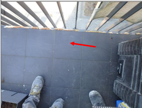
Fot. 04_1. Miejsce wykonania odkrywki – przy silnie skorodowanej obróbce blacharskiej.
