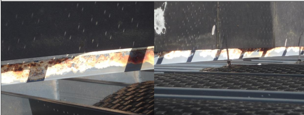
Fot. 18, 20. Stwierdzona korozja obróbek blacharskich balkonu sąsiadującego z balkonem lokalu nr 20.
