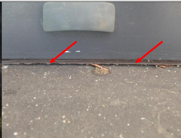
Fot. 37. Widoczne odspojenie uszczelnacza poliuretanowego w miejscu styku ościeżnicy drzwiowej z okładziną ceramiczną.
