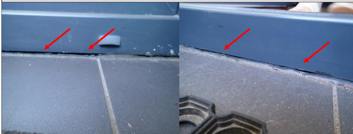
Fot. 24, 26. Miejscowe ubytki uszczelniacza poliuretanowego w miejscu styku ościeżnicy drzwiowej z okładziną ceramiczną.
