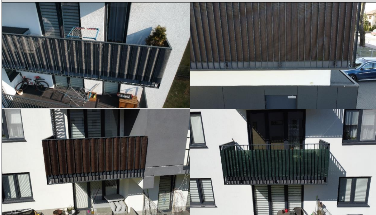
Fot. DR25_ES_3, DR25_EN5, DR25_EE7, DR25_EE9. Część balustrad balkonowych osłonięta przy pomocy nieprzeziernych mat balkonowych uniemożliwiających ocenę obróbek blacharskich.
