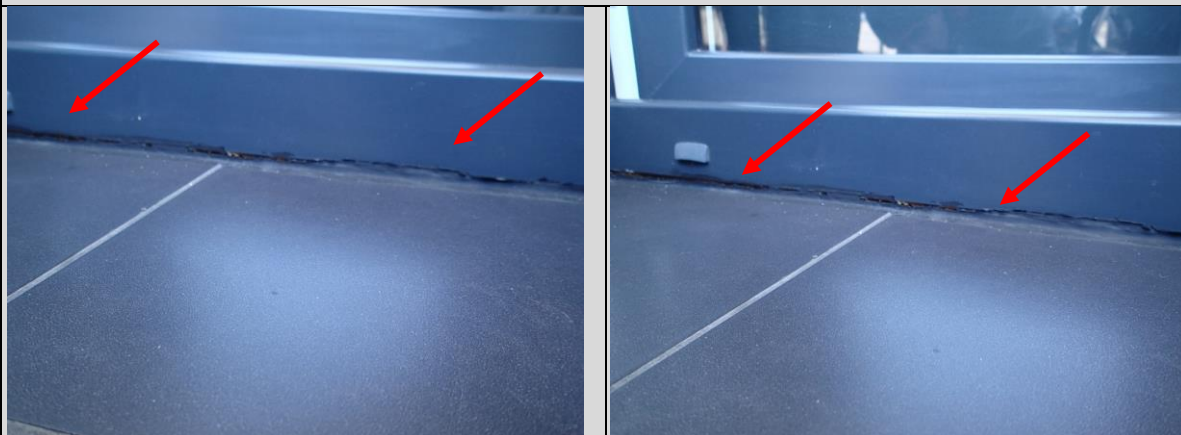
Fot. 8, 9. Odspojenia i ubytki uszczelniacza poliuretanowego w miejscu styku ościeżnicy drzwiowej z okładziną ceramiczną.
