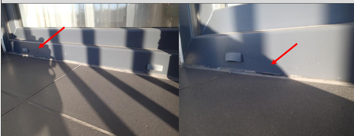
Fot. 14, 15. Miejscowe ubytki uszczelniacza poliuretanowego w miejscu styku ościeżnicy drzwiowej z okładziną ceramiczną.
