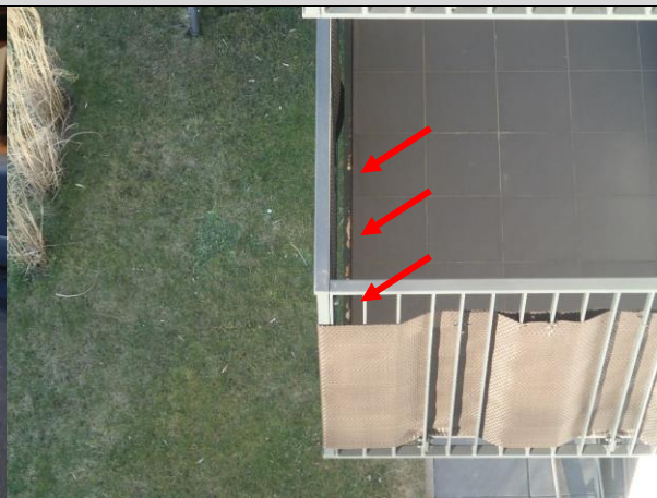
Fot. 20. Korozja obróbek blacharskich balkonów sąsiadujących w lokalem nr 55.
