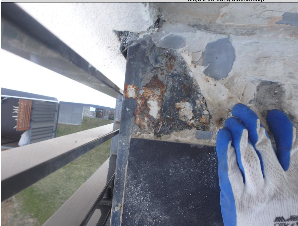
Fot. 02_10. Pod płytką stwierdzona zawansowana korozja obróbki blacharskiej – znacznie większa niż ta obserwowana na widocznej krawędzi okapu.
