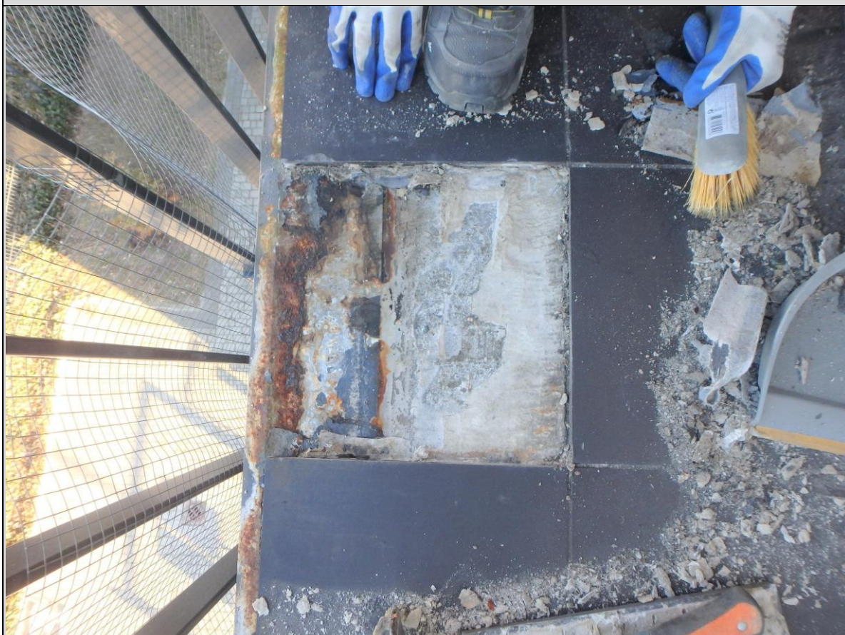
Fot. 04_6. Pod płytką stwierdzona zawansowana korozja obróbki blacharskiej – znacznie większa niż ta obserwowana na widocznej krawędzi obróbki.
