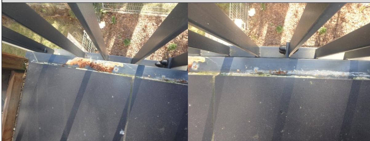
Fot. 12, 13. Stwierdzona korozja krawędziowych obróbek blacharskich. Zaobserwowano prawidłowość silniejszej korozji w miejscu styku obróbki z okładziną ceramiczną niż w strefie kapinosu.
