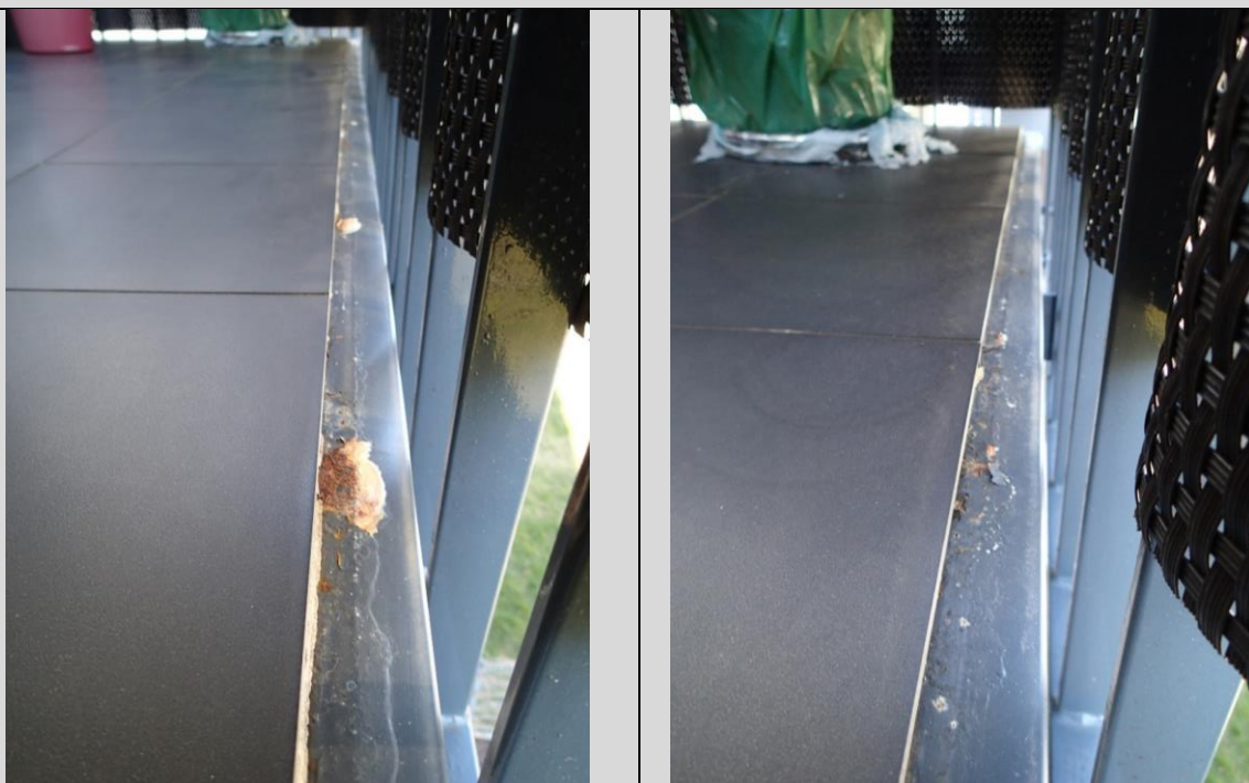
Fot. 2, 3. Stwierdzona korozja krawędziowych obróbek blacharskich. Zaobserwowano tendencję do silniejszej korozji w miejscu styku obróbki z okładziną ceramiczną niż w strefie kapinosu.
