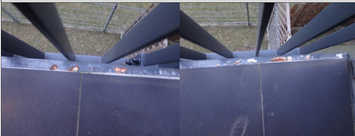
Fot. 9, 10 . Stwierdzona korozja krawędziowych obróbek blacharskich. Zaobserwowano tendencję do silniejszej korozji w miejscu styku obróbki z okładziną ceramiczną niż w strefie kapinosu
