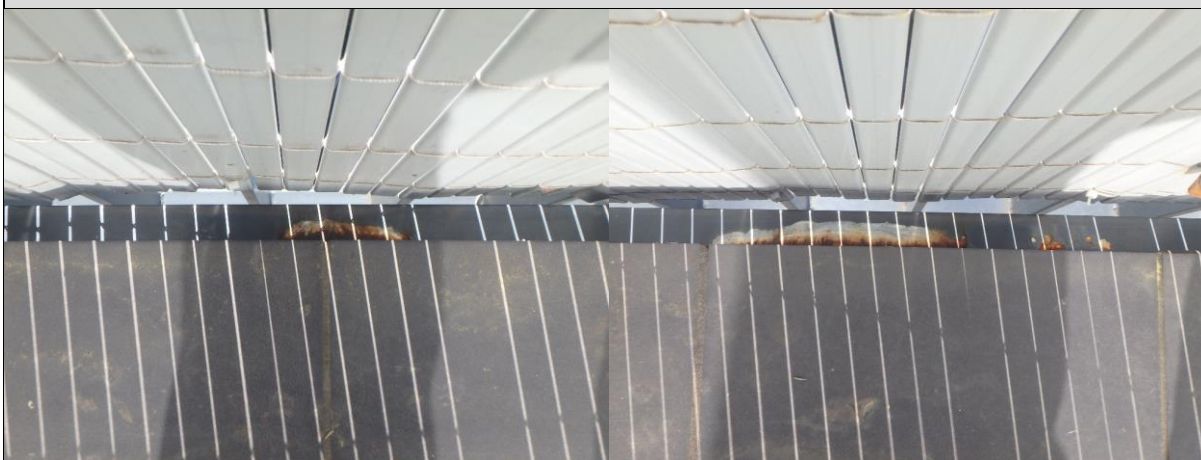
Fot. 5, 6. Stwierdzona korozja krawędziowych obróbek blacharskich. Zaobserwowano tendencję do silniejszej korozji w miejscu styku obróbki z okładziną ceramiczną niż w strefie kapinosu
