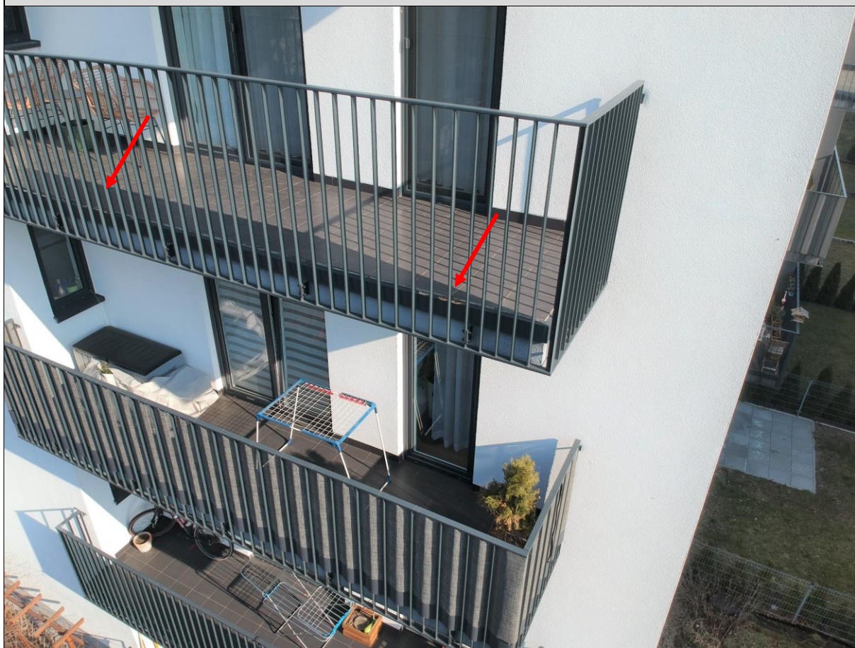
Fot. DR25_ES1. Przykład skorodowanej obróbki blacharskiej na elewacji południowej. Czerwonymi strzałkami oznaczono miejsca zaobserwowanej korozji.
