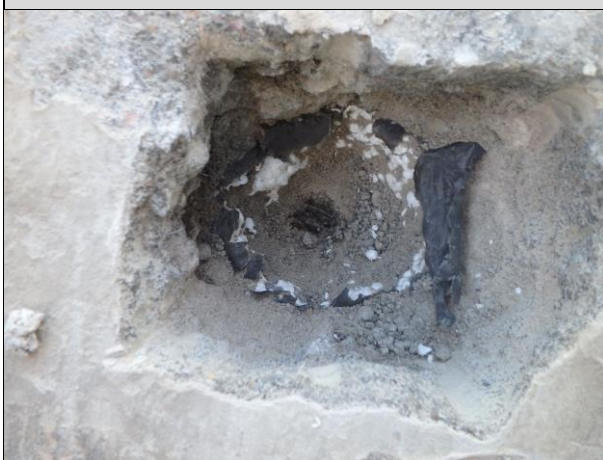
Fot. 04_11. Pod styropianem na powierzchni płyty stropowej obecność izolacji z papy.
