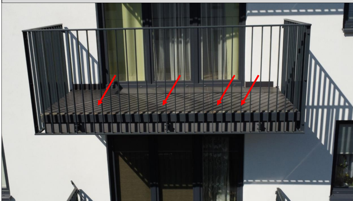
Fot. DR25_EE8. Przykład skorodowanej obróbki blacharskiej na elewacji wschodniej. Czerwonymi strzałkami oznaczono miejsca zaobserwowanej korozji.
