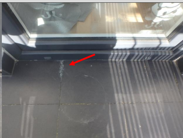
Fot. 15. Widoczne wysolenia powierzchni na powierzchni fug świadczące o obecności zawilgocenia pod powierzchnią okładziny ceramicznej.
