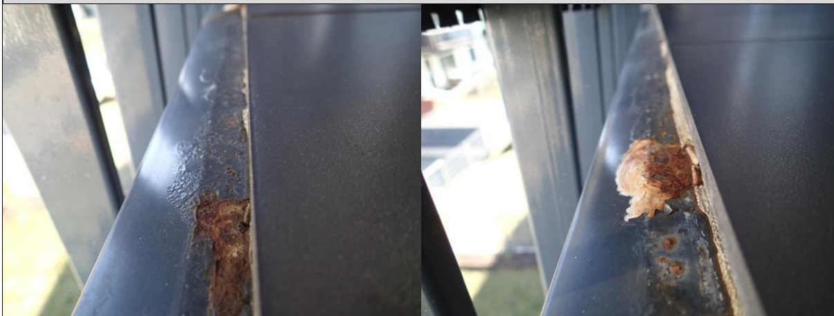
Fot. 7, 9 . Stwierdzona korozja krawędziowych obróbek blacharskich. Zaobserwowano tendencję do silniejszej korozji w miejscu styku obróbki z okładziną ceramiczną niż w strefie kapinusu.
