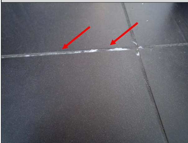
Fot. 9 . Stwierdzona miejscowe wysolenia na powierzchni fug świadczące o obecności wilgoci w strefie podpłytkowej.
