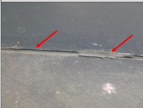
Fot. 16. Przykładowe ubytki i odspojenia uszczelniacza poliuretanowego w miejscu styku ościeżnicy drzwiowej z okładziną ceramiczną.
