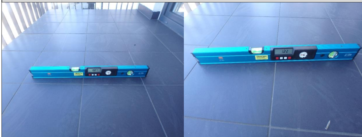
Fot. 17, 18. Zmierzona wartość spadku od 0,87% do 1,22%, tj. miejscowo poniżej wartości projektowanej w wymiarze 1%.
