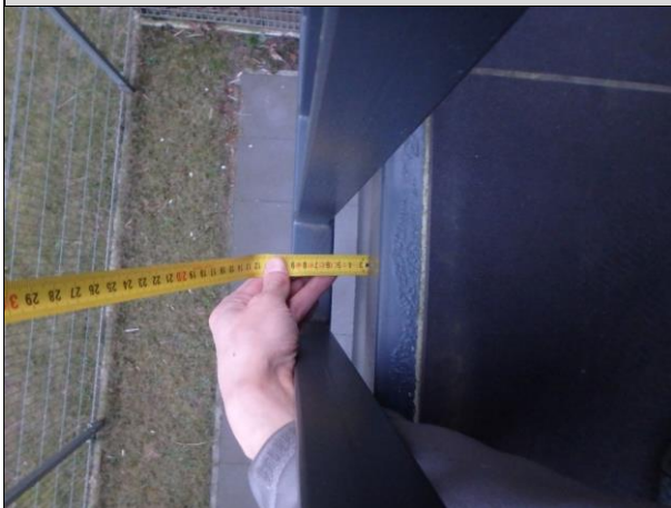
Fot. 17. Miejscowe nieprawidłowości w wielkości kapinosu obróbki blacharskiej. Tu 25mm (powinno być min 30mm)
