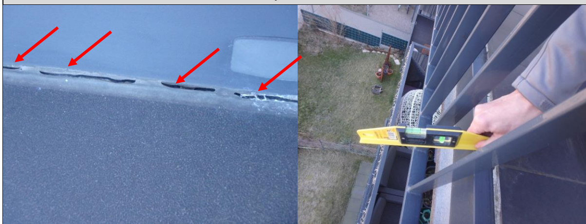
Fot. 24 Miejscowe ubytki uszczelniacza poliuretanowego w miejscu styku ościeżnicy drzwiowej z okładziną ceramiczną.
