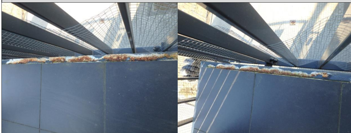
Fot. 9, 10. . Stwierdzona silna korozja krawędziowych obróbek blacharskich. Zaobserwowano przy tym tendencję do silniejszej korozji w miejscu styku obróbki z okładziną ceramiczną niż w strefie kapinosu.
