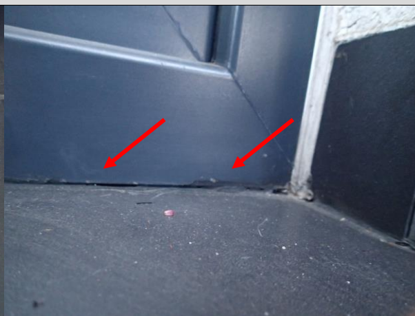
Fot. 11 . Miejscowe odspojenia i braki uszczelniacza poliuretanowego w miejscu styku ościeżnicy drzwiowej z okładziną ceramiczną.
