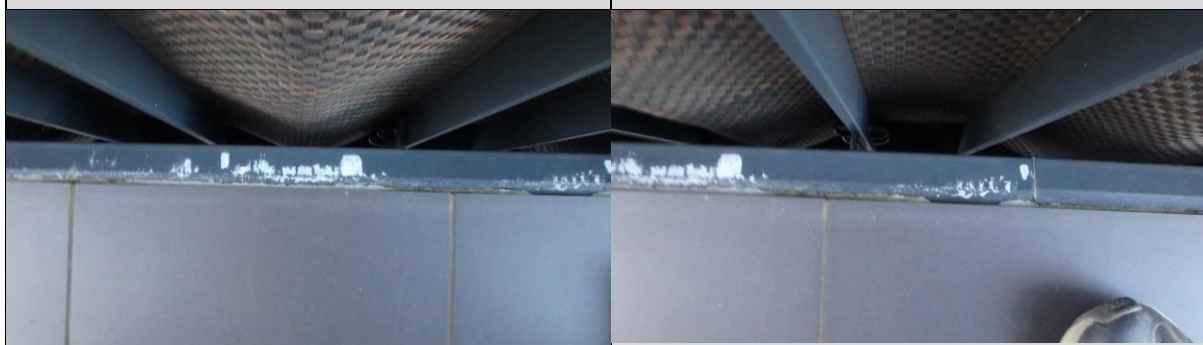
Fot. 6, 7. Obserwowany nalot węglanu wapnia świadczący o wypłukiwaniu z warstw posadzkowych związków cementu.
