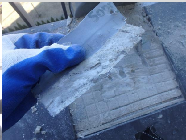
Fot. 01_13. Zastosowane taśmy uszczelniające z fizeolinową częścią montażową. Taśmy przyklejane do obróbki przy pomocy kleju. Rozwiązanie dopuszczalne aczkolwiek lepszym (zdaniem zespołu opiniującego) rozwiązaniem jest stosowanie „samoprzylepnych” taśm butylowych.
