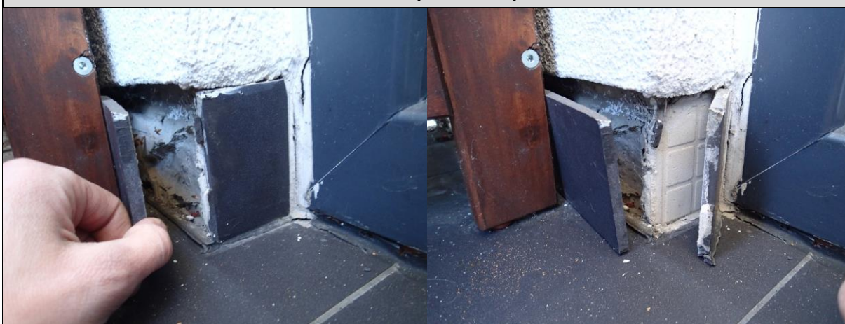
Fot. E_10, 11. Miejscowe odspojenie płytki cokołowej
