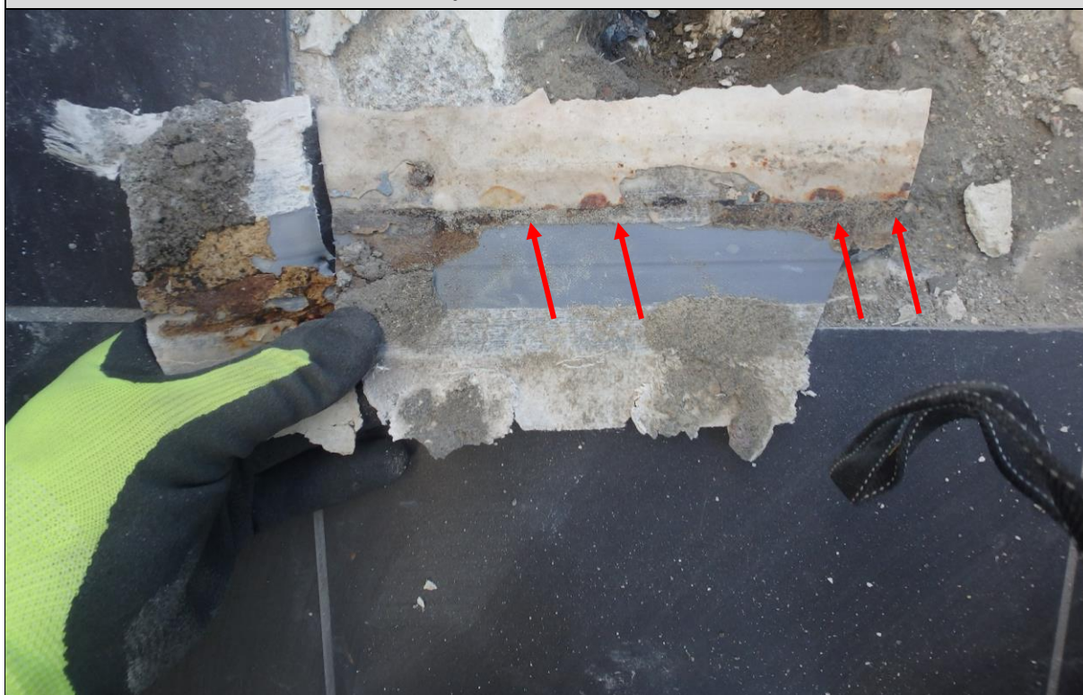
Fot. 03_22 (kadr). Na taśmie izolacyjnej stwierdzone zabarwienie korozyjne pochodzące z korodujących obróbek blacharskich.
