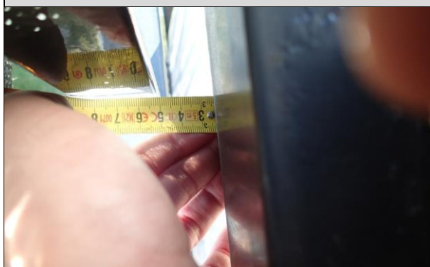
Fot. 12. Miejscowe nieprawidłowości w wielkości kapinosu obróbki blacharskiej. Tu 24mm (powinno być min 30mm)
