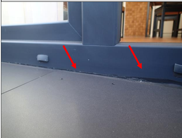
Fot. 15. Miejscowe ubytki uszczelnacza poliuretanowego w miejscu styku ościeżnicy drzwiowej z okładziną ceramiczną.
