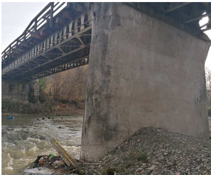
Widok uszkodzonej powierzchni betonowej podpory
