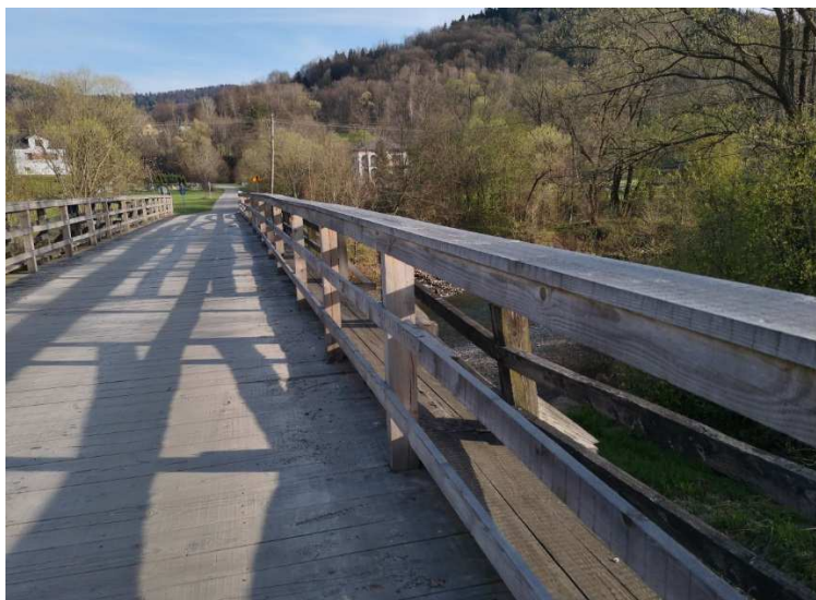
Widok ogólny mostu od strony północnej – widoczne elementy pomostu oraz bariery drewniane
